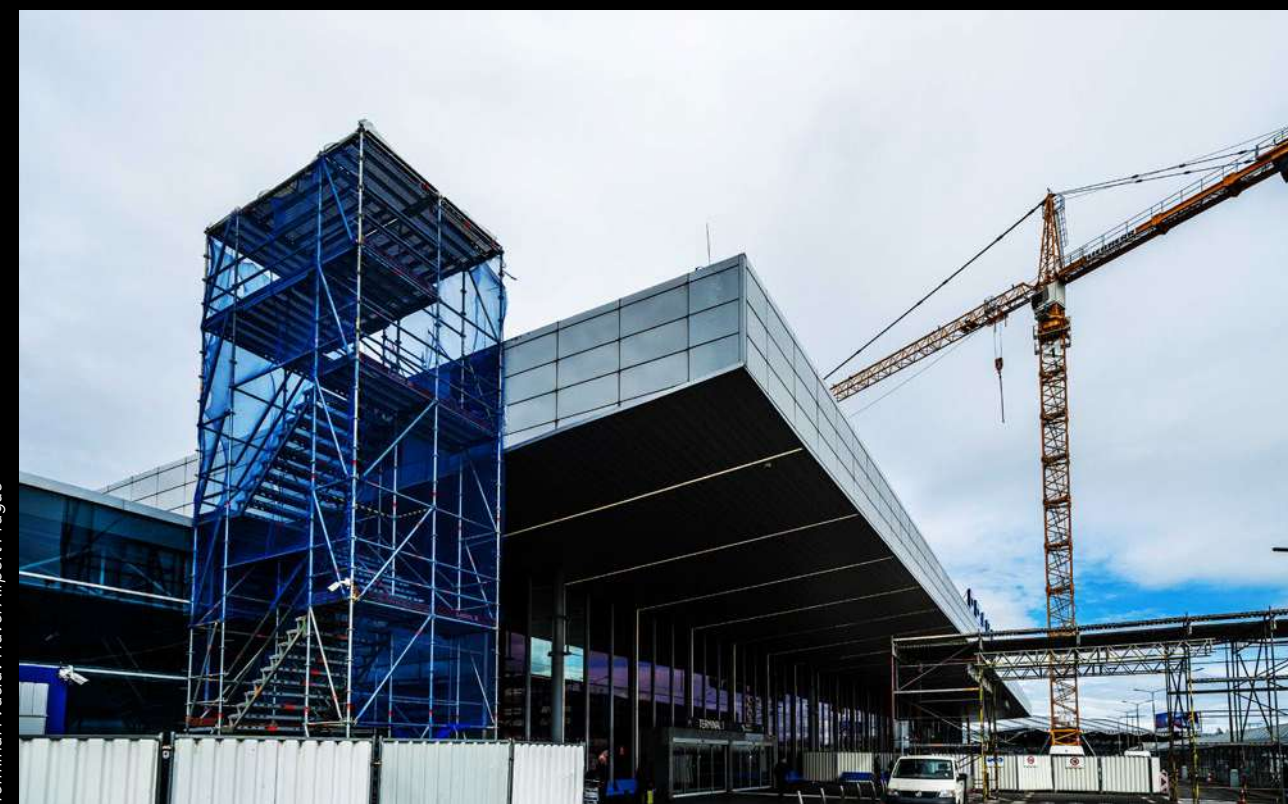
Terminal I, Letiště Václava Havla Praha, Terminal I Václav Havel Airport Prague
