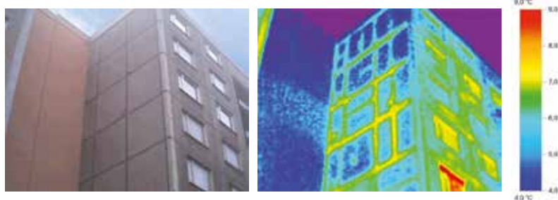
Na štítu objektu je zachycena porucha tepelné izolace uvnitř panelů.
